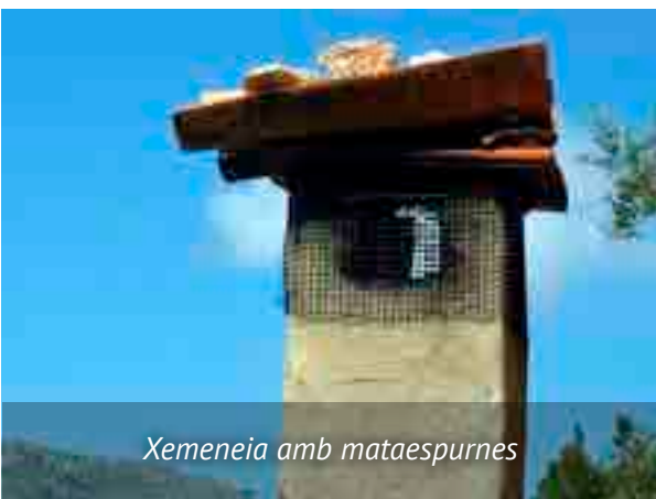
Després de l'incendi: la porxada feta amb material poc inflamable ha contribuït a que el foc no s'hagi estès a l'habitatge
