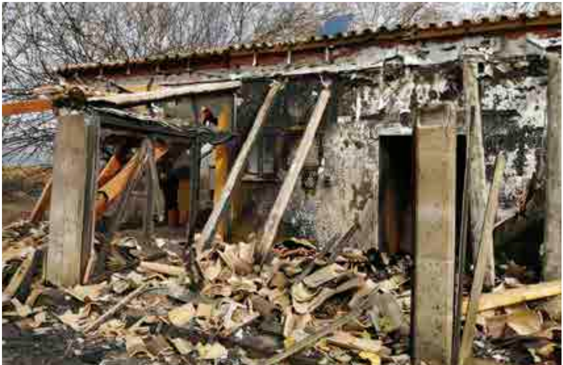
Mobiliari exterior de plàstic afectat per un incendi forestal
